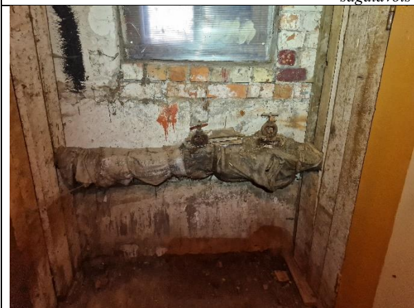
6.att. Apkures cauruļvadu siltumizolācija sliktā stāvoklī
