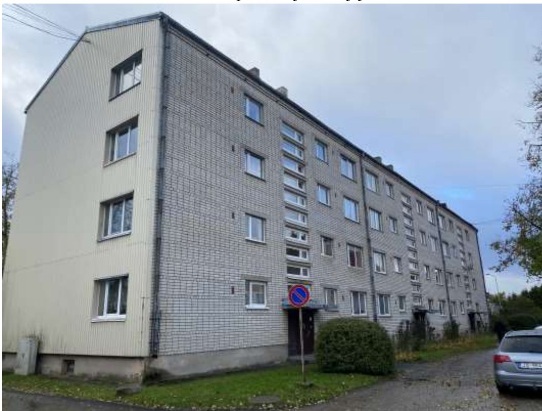
4.2.6.att. Sala, mitruma piesātinājuma bojājumi, ēkas stūros
