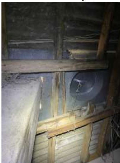
4.8.3.att. Jumta konstrukcijas, notecējumi
