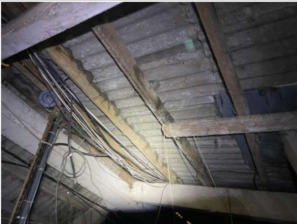
4.8.4.att. Jumta konstrukcijas, notecējumi
