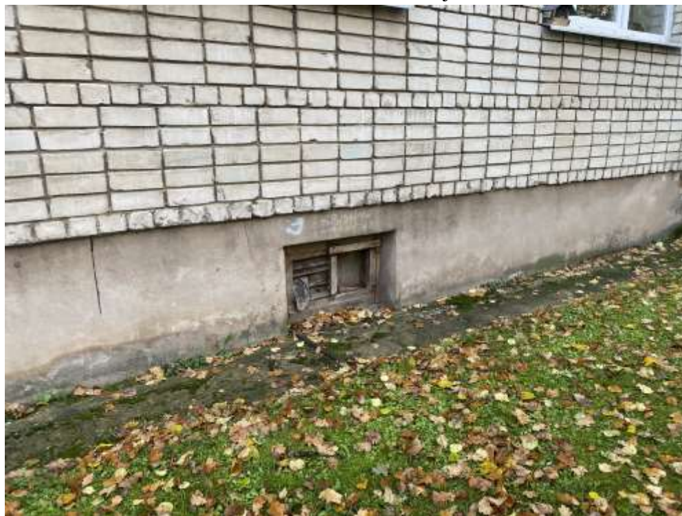
4.2.4.att. Sala, mitruma piesātinājuma bojājumi
