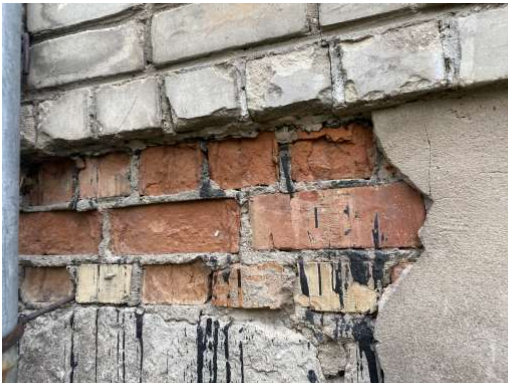
4.2.5.att. Sala, mitruma piesātinājuma bojājumi, ēkas stūros
