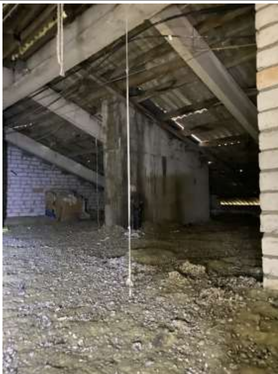
4.8.2.att. Jumta konstrukcijas, notecējumi
