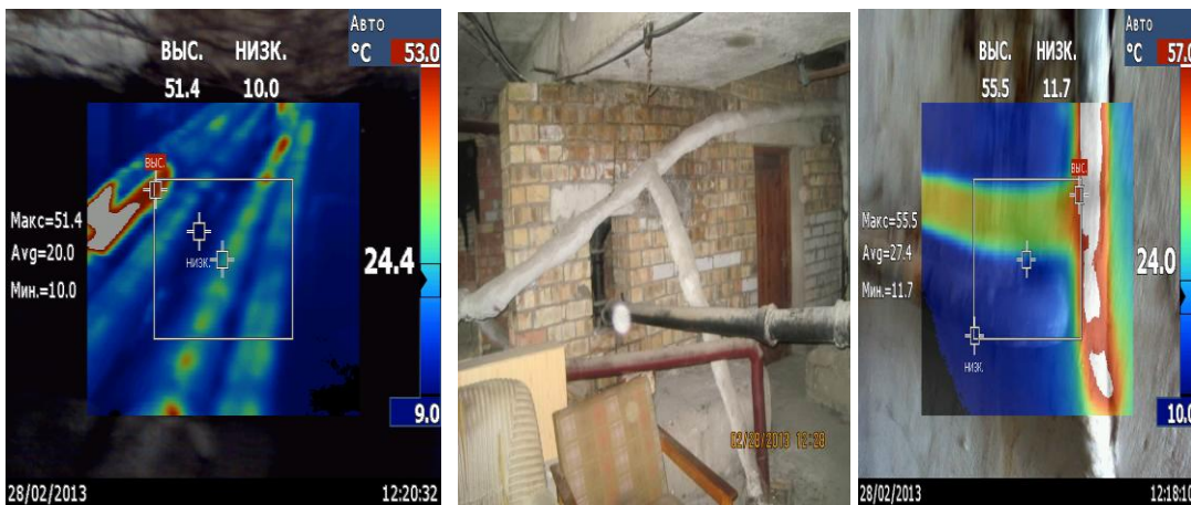
Siltumizolācija maģistrāliem apkures piegādes vadiem.
