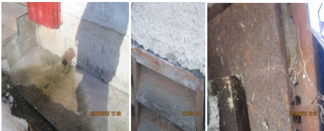
Cokola daļai pa perimetru nepieciešama hidroizolācija un siltināšana, izbūvējot betona apmali un lietus ūdeņu novadīšanu no pamatiem, kā arī pagraba ventilācijas atveru iebūve.
