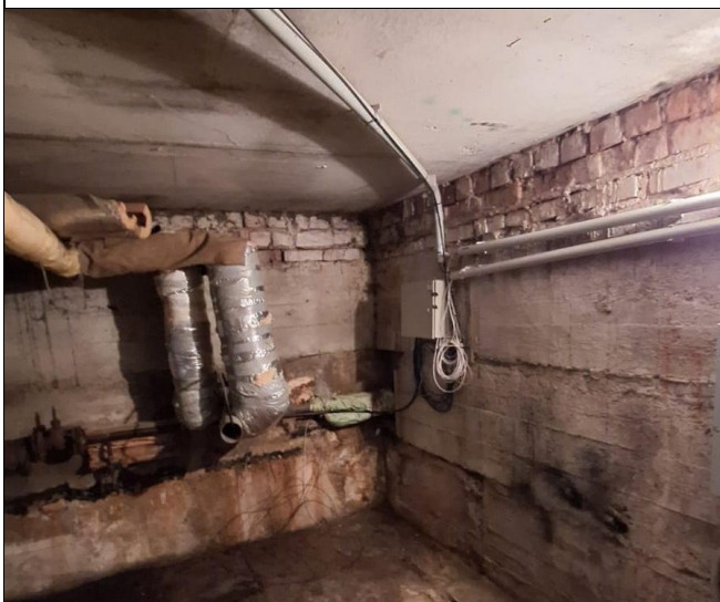
5.4.3. att. Apkures sistēmas cauruļvadi; bojājumu vieta
