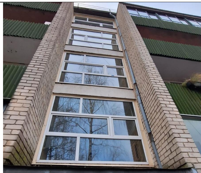
4.13.3. att. PVC konstrukcijas logi kāpņu telpās
