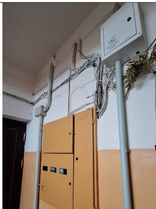
5.9.2. att. Elektroinstalācija kāpņu telpās; elektrības skaitītāji
