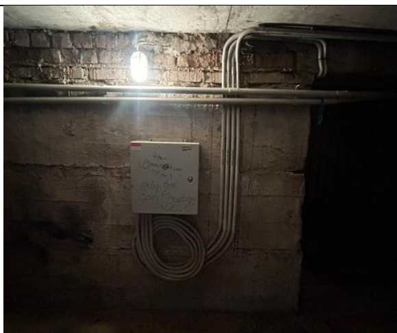
5.9.3. att. Elektroinstalācija pagrabā
