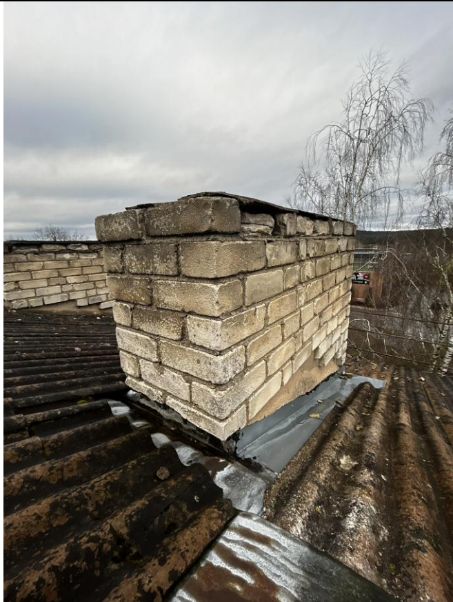
4.16.1. att. Ventilācijas kanālu izvads
