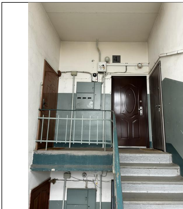
5.9.1. att. Elektroinstalācija kāpņu telpās; elektrības skaitītāji
