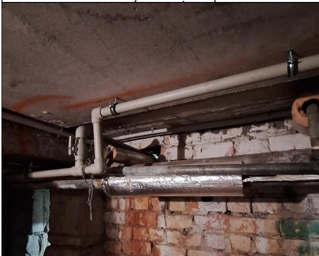
5.1.1. att. Ūdens apgādes cauruļvadi
