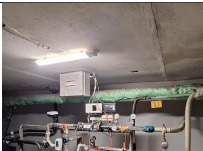
5.9.4. att. Elektroinstalācija pagrabā
