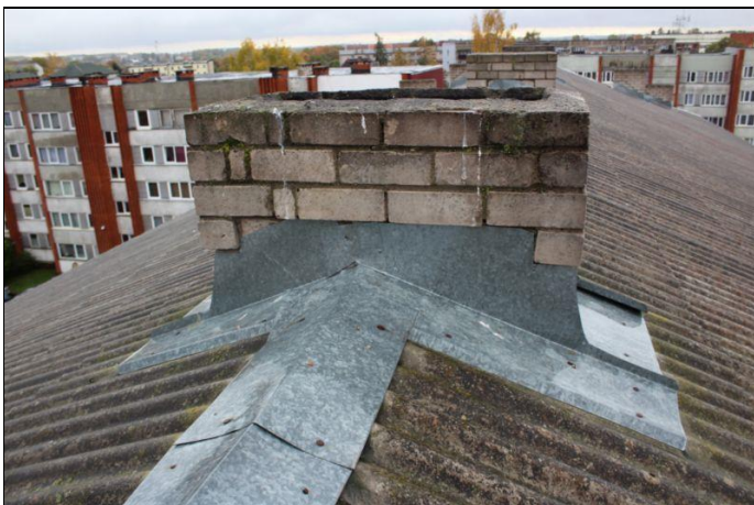
4.16.3. att. Virsjumta ventilācijas izvadi
