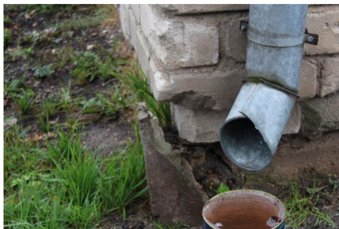
4.1.2. att. Mūra erozija cokola daļā
