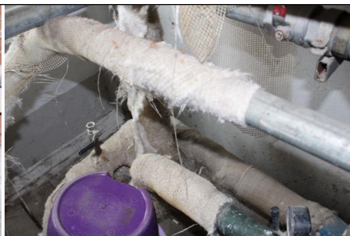
5.4.2. att. Siltumapgādes cauruļvadi
