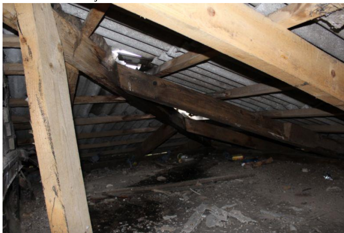
4.8.4. att. Jumta seguma bojājumi
