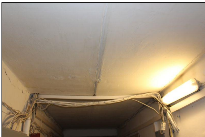
4.6.1. att. pārsegumu paneļu savstarpēja nobīde
