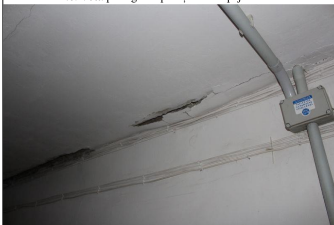
4.6.3. att. Pārsegumu bojājumi
