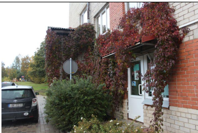
4.2.15. att. Vītēnaugi uz ēkas fasādes
