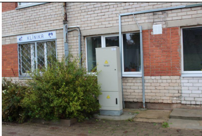
5.9.1. att. Elektroapgādes ievadskapis
