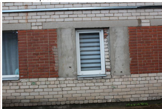
4.13.4. att. Daļēji aizmūrēta loga aila
