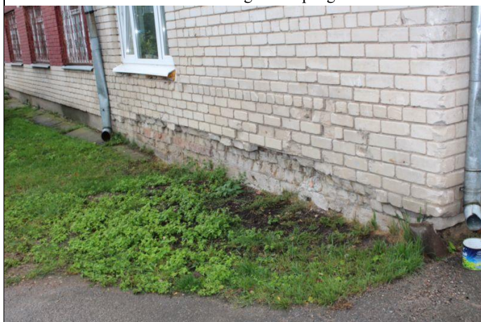
4.1.9. att. Mūra erozija cokola daļā
