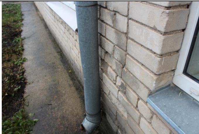
4.1.11. att. Betona aizsargapmale, bojājumi notekas
