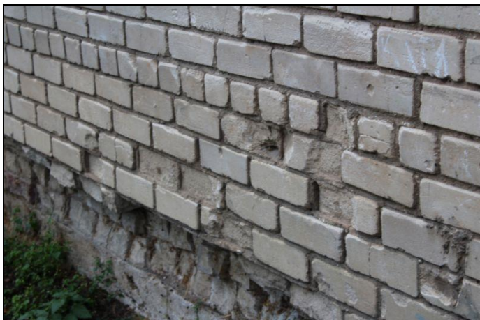
4.2.9. att. Ķieģeļu mūra erozija
