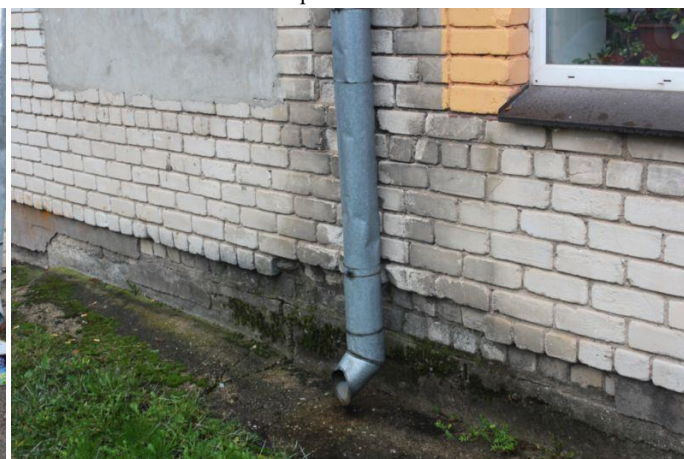
4.1.10. att. Bojājumi notekas zonā
