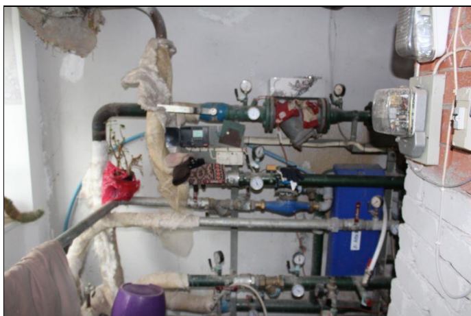
5.4.1. att. Ēkas siltummezgls
