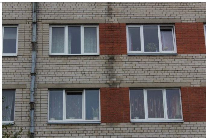
4.2.10. att. Ārsienas bojājumi mitruma un sala ietekmē – bioloģiskais apaugums
