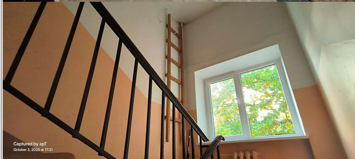
Ēkas ziemeļu pusē atrodas metāla kāpnes – ugunsdzēsības vajadzībām. Kāpnes ar virspusēju koroziju.
