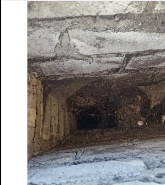
8.att. Nepieciešams veikt ventilācijas šahtu tīrīšanu
