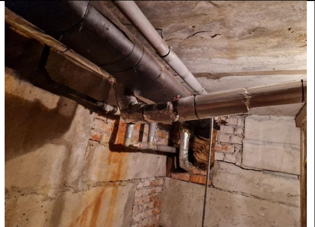
7.att. Veikta daļēja karstā ūdens cauruļvadu siltināšana. Daži posmi bez izolācijas slāņa, citos posmos izmantots nepiemērots izolācijas slānis.
