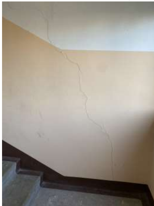
4.2.7.att. Plaisas mūra sienās, kāpņu telpa
