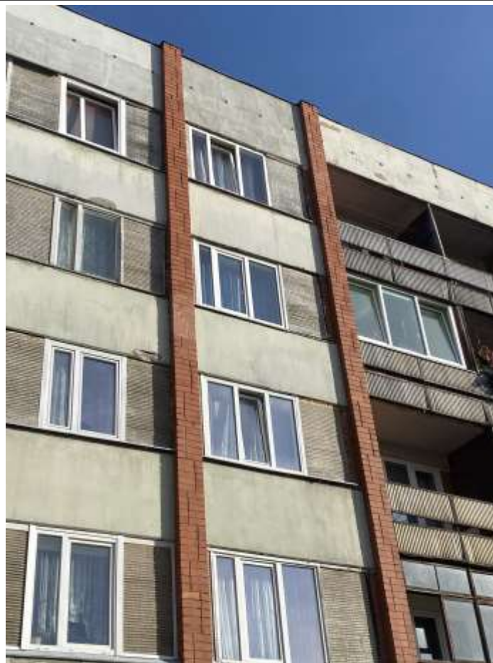
4.2.4.att. Sala, mitruma piesātinājuma bojājumi
