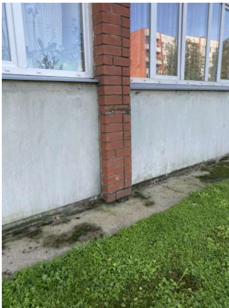
4.2.3.att. Ārsienu bojājumi pilastru zonās
