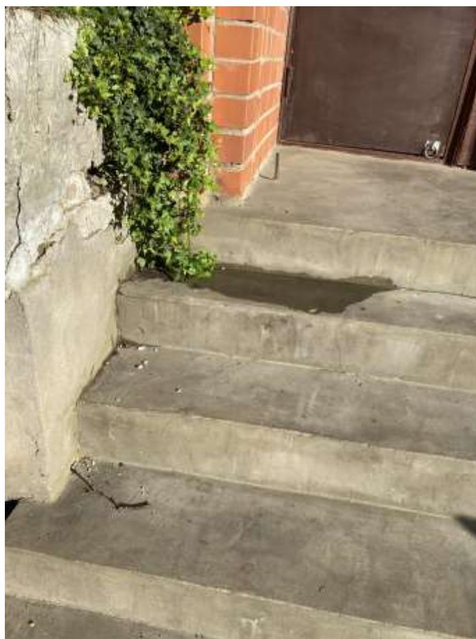
4.10.4.att. Uz kāpnēm lokāli mitruma bojājumi, kuri vēlāk var radīt lokālas plaisas uz kāpņu konstrukciju. Nepareizi izbūvēts kritums kāpnēm.
