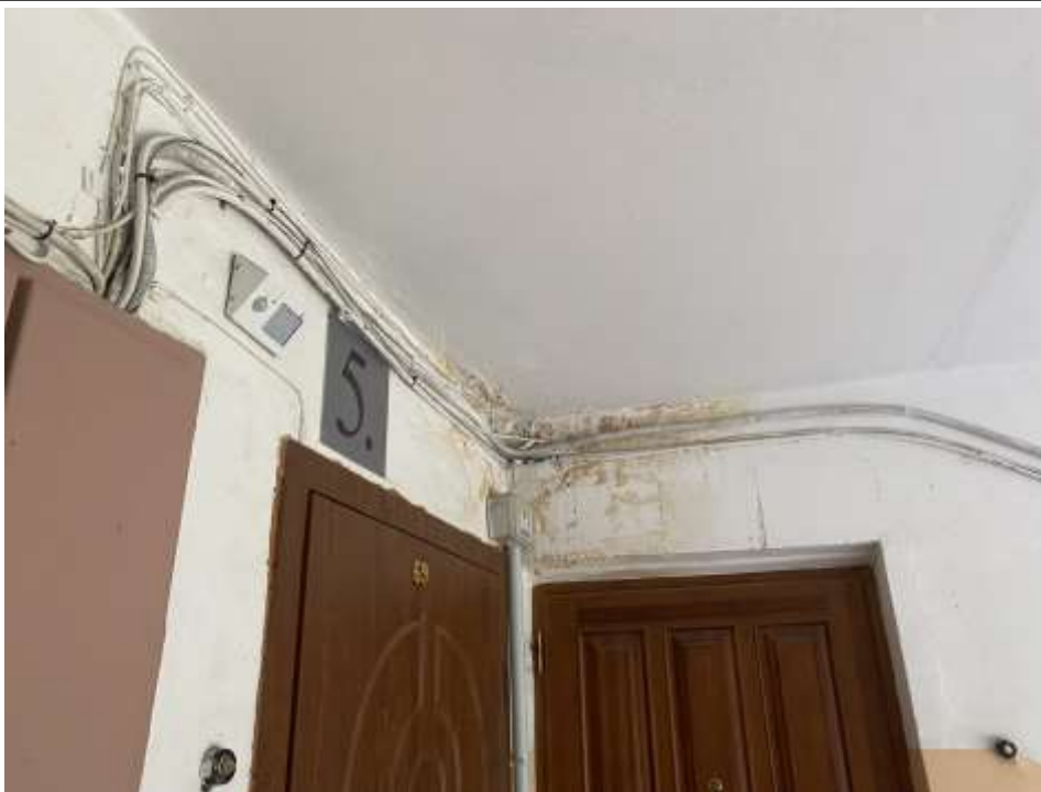
4.2.8.att. Iekštelpu bojājumi
