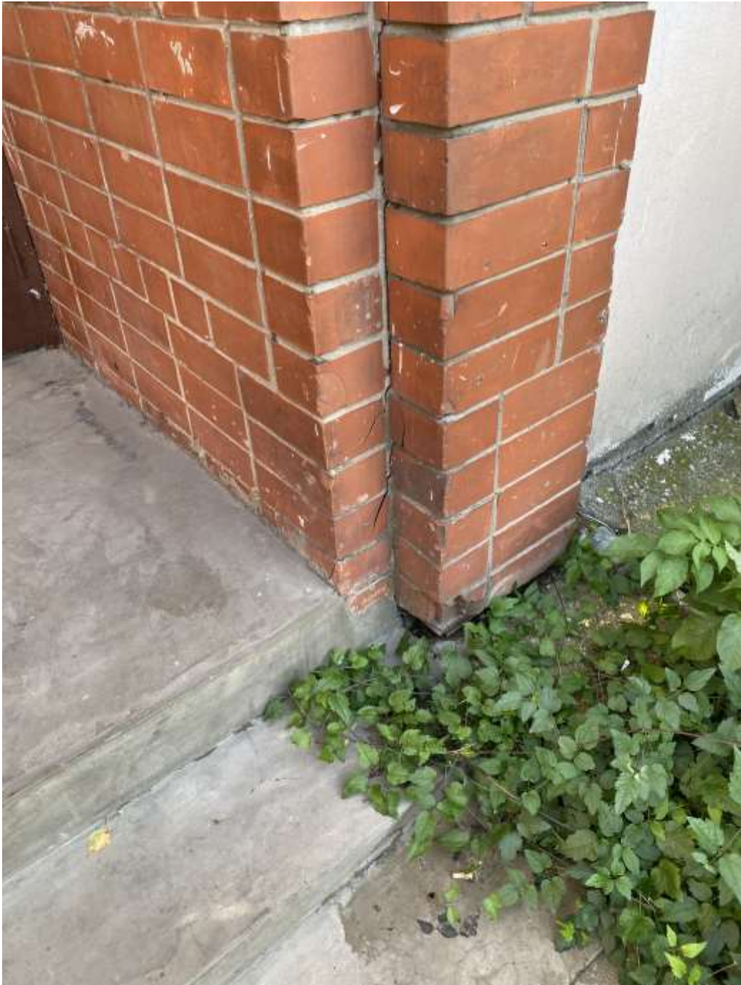
4.2.1.att. Ārsienu bojājumi pilastru zonās
