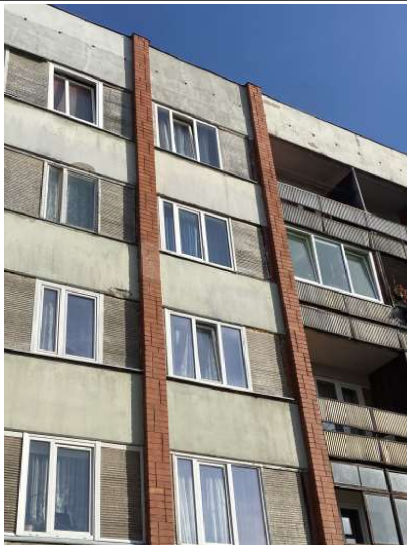
4.4.1.att. Sala, mitruma piesātinājuma bojājumi
