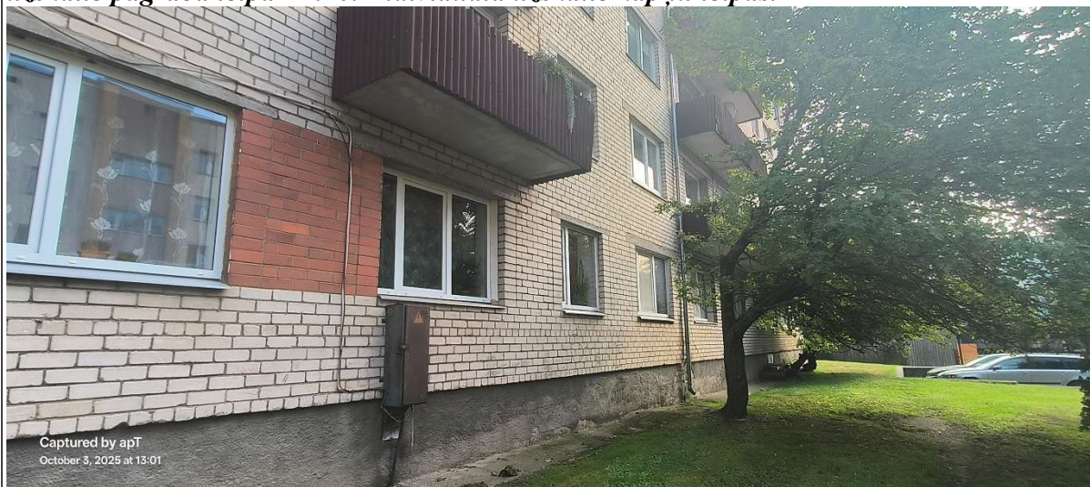
Ēkas rietumu pusē vidus daļā uzstādītā ārējā sadalne. Transformatora - komunālā uzskaitē pagraba telpā Nr.10. Individuālā uzskaitē kāpņu telpās.
