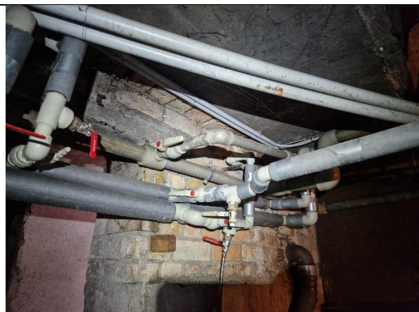
10.att. Karstā ūdens apgādes cauruļvadi nomainīti un tiem ir arī uzklāts siltumizolācijas slānis. Uzklātais siltumizolācijas slānis neatbilst labākajiem pieejamiem tehniskajiem paņēmieniem.
