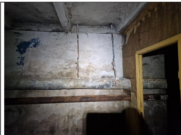
9.att. Apkures cauruļvadi pamatā novecojuši. Atsevišķiem posmiem veikta siltumizolācijas slāņa nomaiņa, vietām palicis vecais siltumizolācijas slānis un vietām siltumizolācijas slānis nav vispār.
