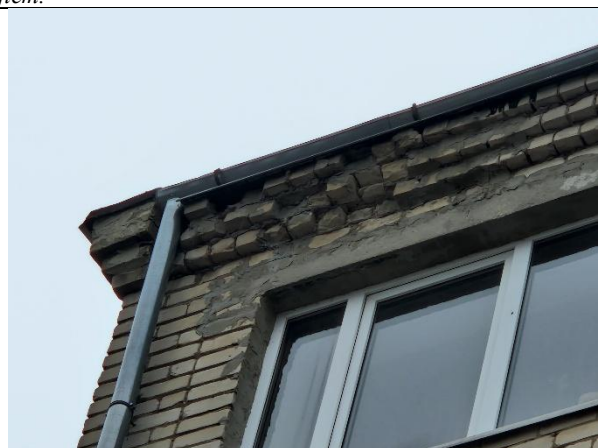
12.att. Pirms ēkas atjaunošanas nepieciešams novērst norobežojošo konstrukciju bojājumus. Jauna siltumizolācijas slāņa uzklāšana uz bojātām konstrukcijām nav pieļaujama.
