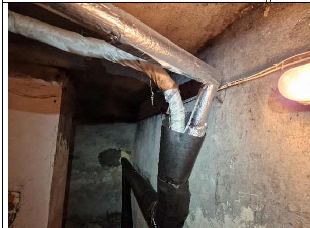
6.att. Cauruļvadiem pagrabā ir daļēji atjaunots siltumizolācijas slānis. Daļai cauruļvadu ir atjaunots siltumizolācijas slānis, daļai ir vecais izolācijas slānis.
