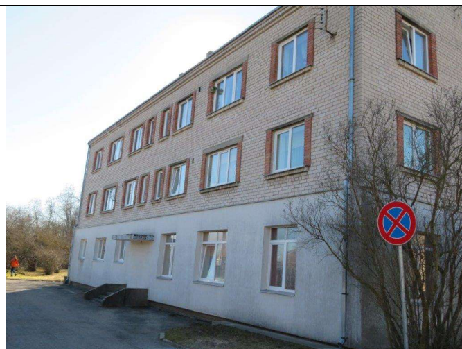
4.2.7. att. Ēkas ārsienas – apmetums 1.stāva līmenī
