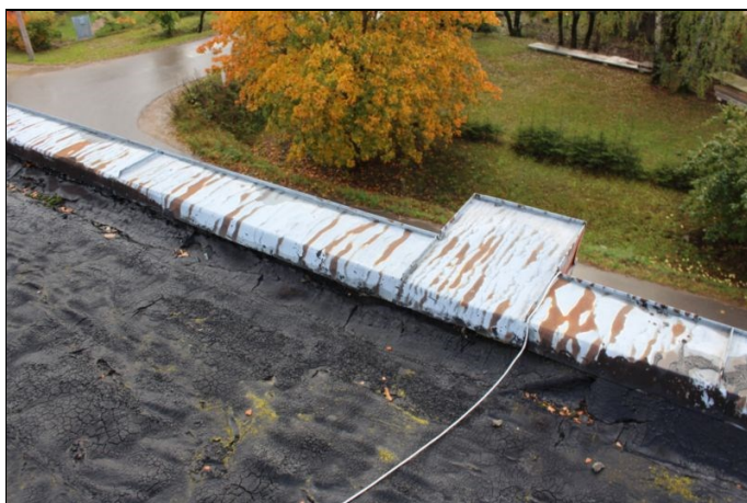
4.8.7. att. Novecojuši, korodējuši skārda elementi
