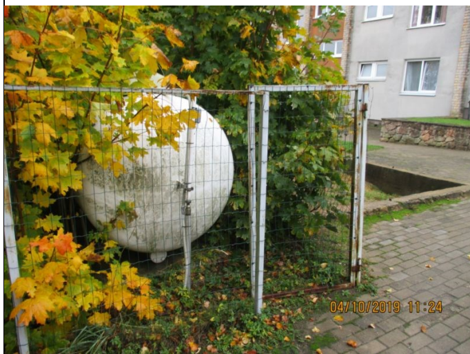
5.4.3. att. Sašķidrinātās gāzes virszemes rezervuārs
