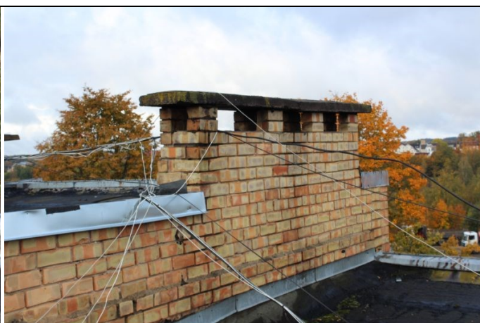
4.8.8. att. Vājstrāvas kabeļi
