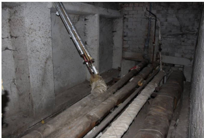
5.2.1. att. Metāla karstā ūdens caurules ar izolāciju
