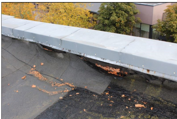
4.8.13.att. Jumta seguma bojājumi, ķieģeļu izdrupumi
