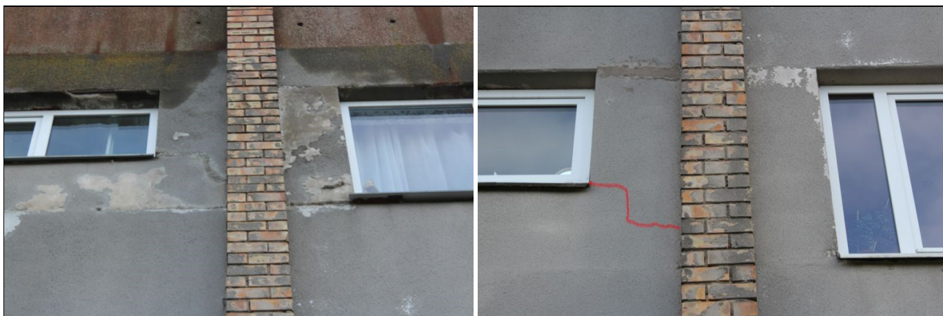
4.2.9. un 4.2.10. att. Ārsienu bojājumi pilastru zonās
