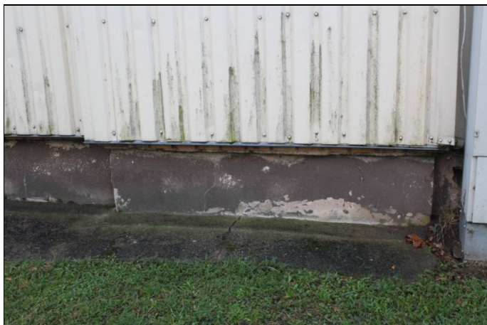
4.1.6. att. Bojāta apdare cokola daļā
