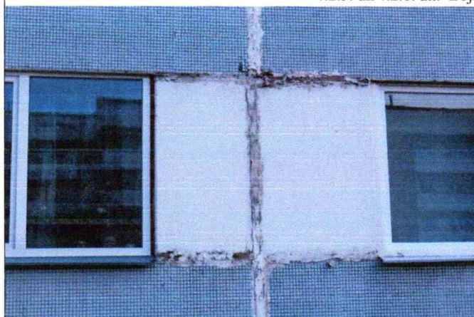
4.2.7. att. Bojājumi starppaneļu šuvēs
