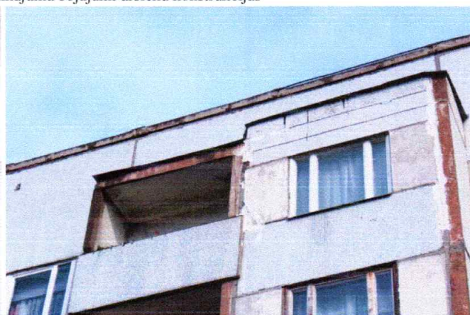
4.2.4. att. Bojājumi starppaneļu šuvēs
