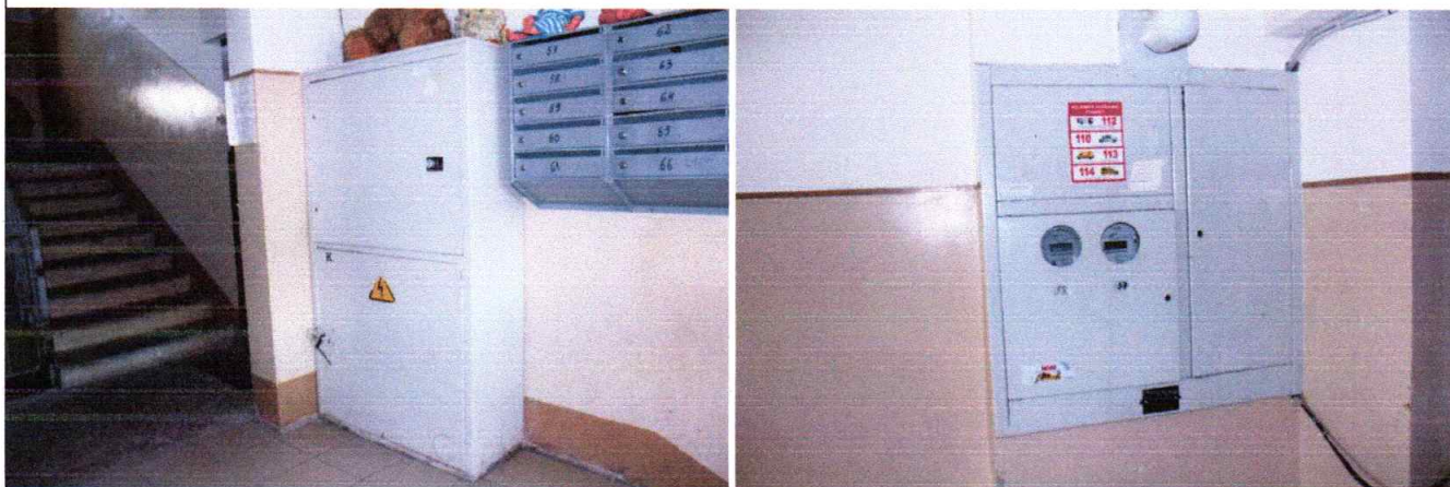
5.9.1. un 5.9.2. att. Elektroinstalācijas elementi
