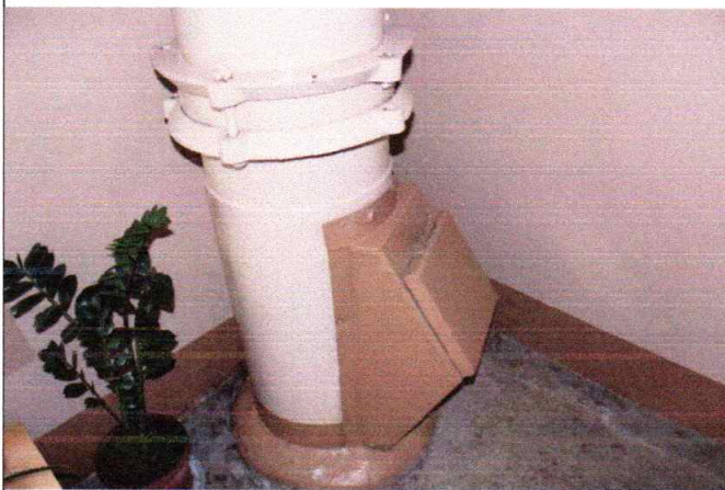
5.7.1. att. Atkritumu vads kāpņu telpā
