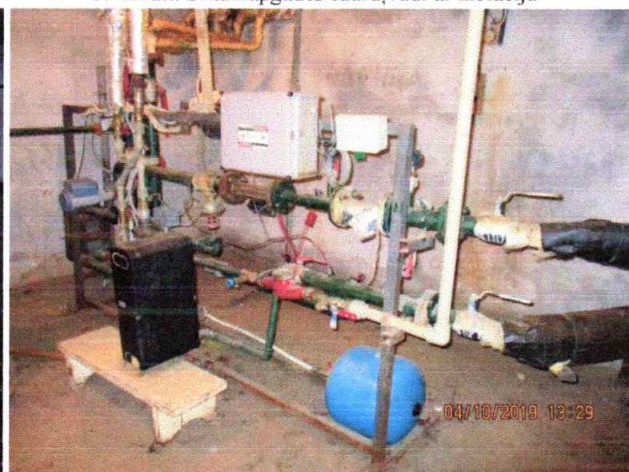
5.4.4. att. Ēkas siltummezgls
