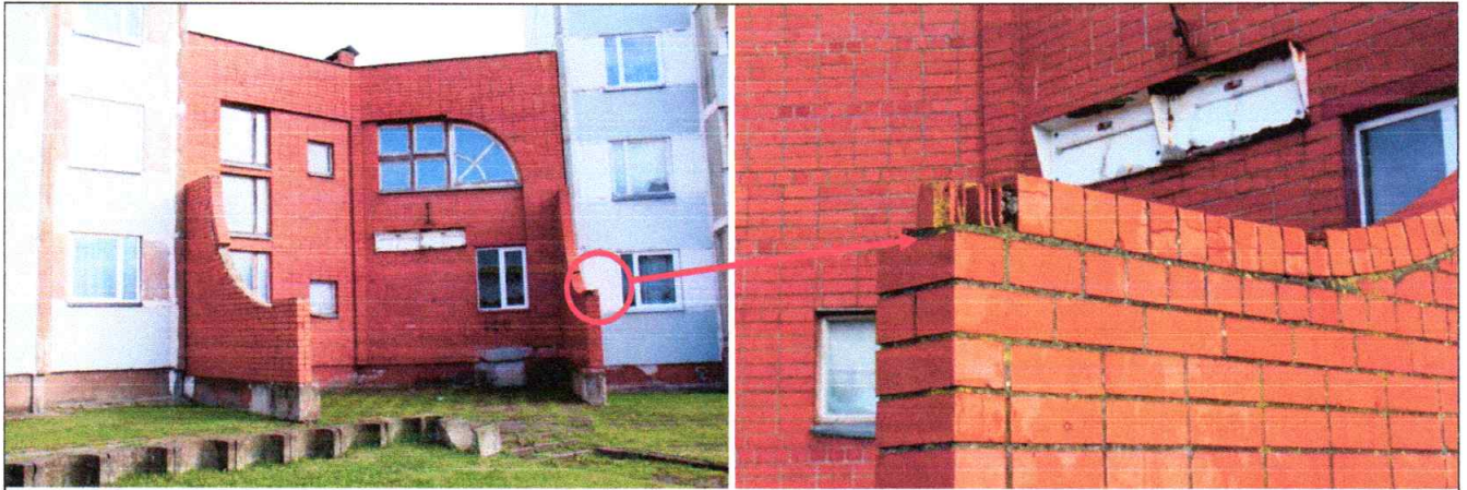
4.2.23. un 4.2.24. att. Mūra erozija
