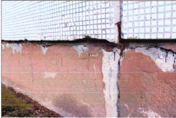
4.1.7.att. plaisas un izdrupumi paneļu savstarpējās savienojumu vietās
