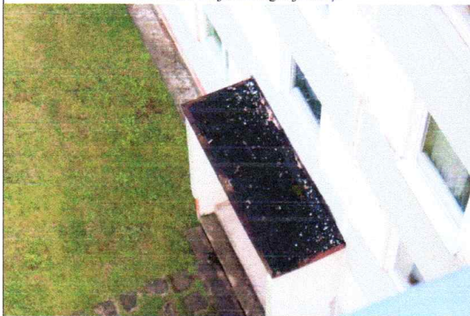
4.9.5.att. bojāts jumtiņa segums
