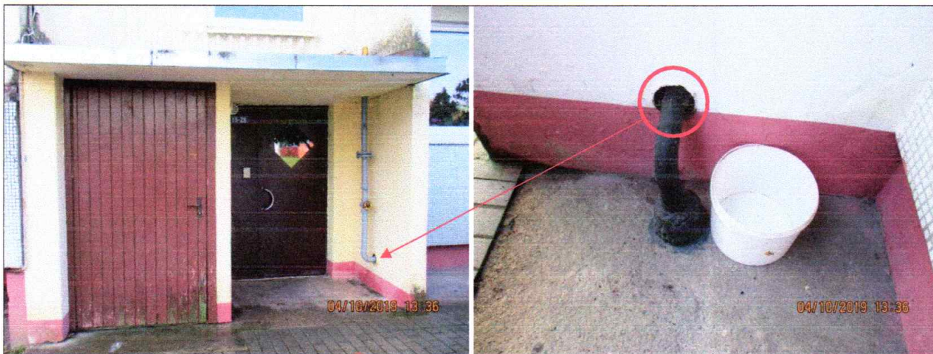
5.8.1. un 5.8.2. att. Centralizētās dabasgāzes ievads
