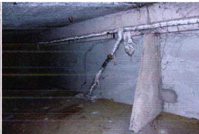
5.4.2. att. Siltumapgādes cauruļvadi ar izolāciju
