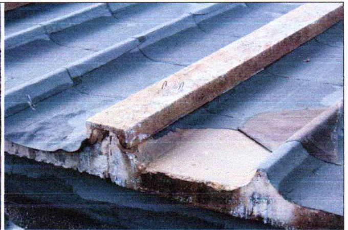
4.8.21.att. Novcojis un bojāts jumta segums
