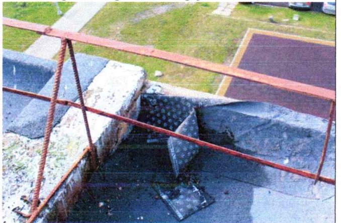
4.8.7. att. Novecojušas/korodējušas jumta drošības margas
