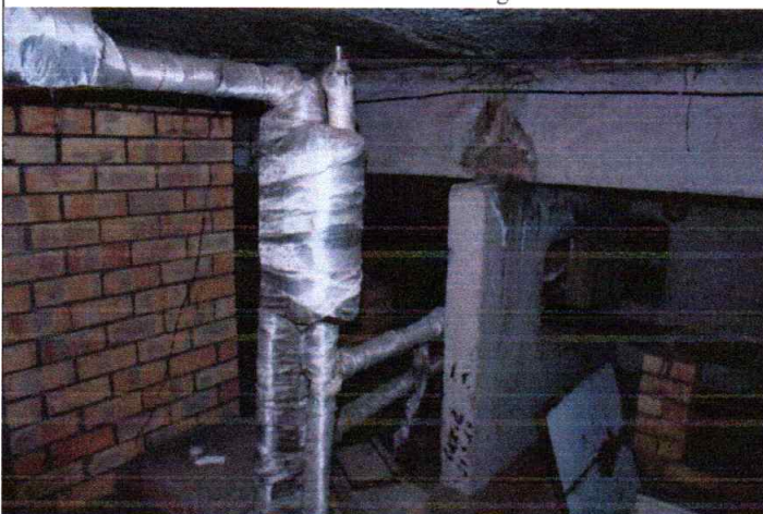
5.4.3. att. Apkures cauruļvadi ar izolāciju ēkas bēniņu stāvā
